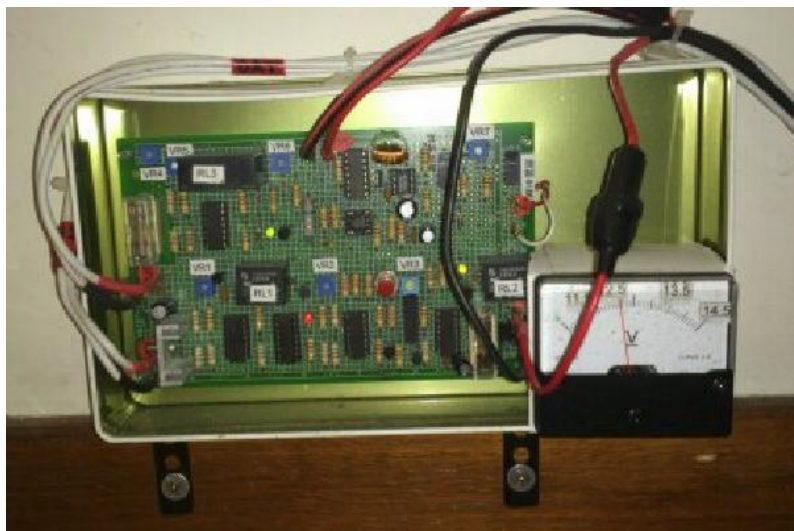
ソーラー充電器稼働中
